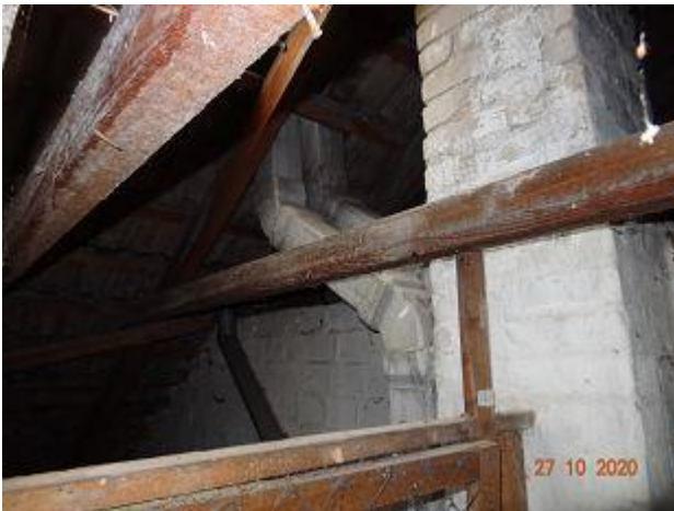
F 039: AZ Abluftkanäle über Dach
