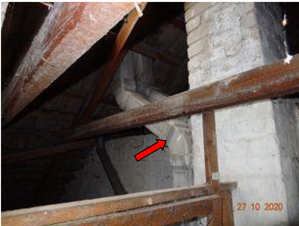
F 039: AZ- Abluftkanäle über Dach
