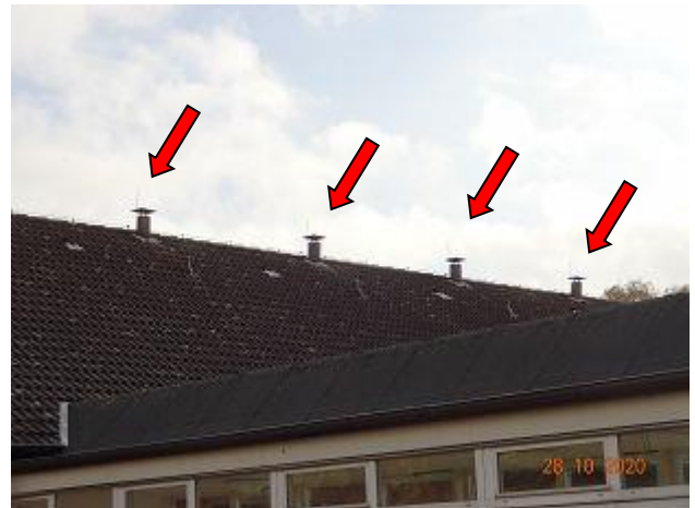
F 086: AZ Abluftkanäle über Dach
