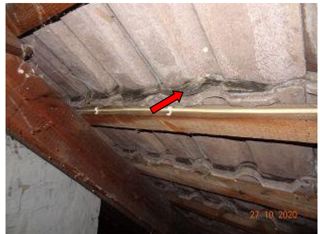
F 040: KMF zwischen Dachpfannen
