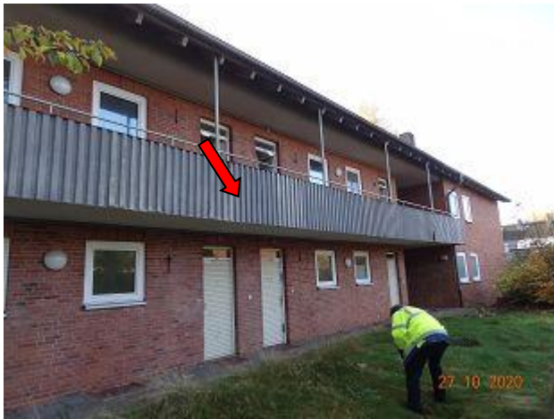
F 006: Balkonbrüstung, Probe P1 ( Chrysotilasbest )
