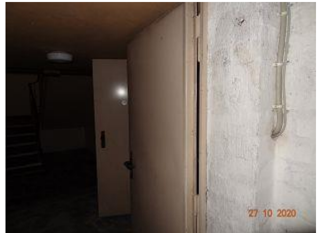
F 032 + 034: Blechtüren mit KMF
